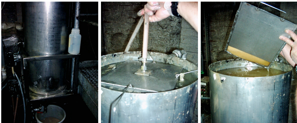
Abb.1: Klarwassertank. Links: Sedimator in kleinem Maßstab, Prozesswasser wird von unten in den Kegel eingeströmt. Mitte und Rechts: Sedimantorkomponenten, eine Filterbox enthält einen Schwimmfilter mit einer Porengröße von 1mm.
