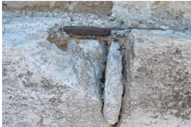
Abb. 32: Pi-förmige Eisenklammer (Tempel der Fortuna Augusta).
